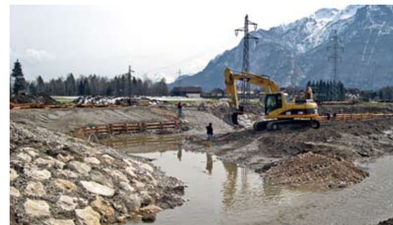
Im unteren Aufweitungsberreich wird Material aufgeschüttet und damit die zentralen Inseln vorbereitet.
